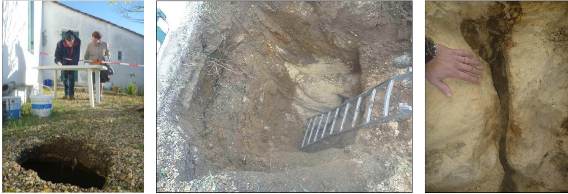
Figure 16 : Apparition d'un fontis à LATRESNE (Gironde) lié au débouffrage d'une fissure karstique (visible au fond derrière l'échelle) ayant entraîné les terrains superficiels [Source : Bureau des Carrières de Gironde]
